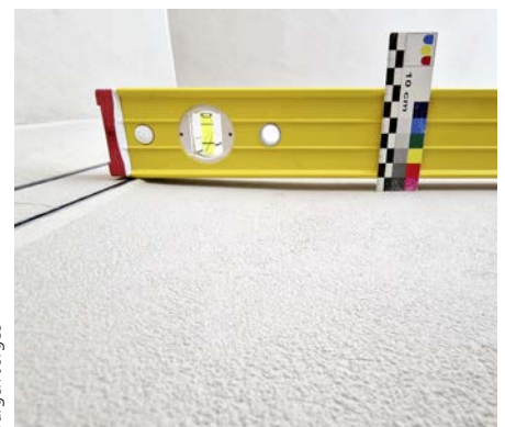
(2) Der Anschluss an die Duschrinne ist mangelhaft. Das Wasser kann nicht in die Rinne ablaufen
