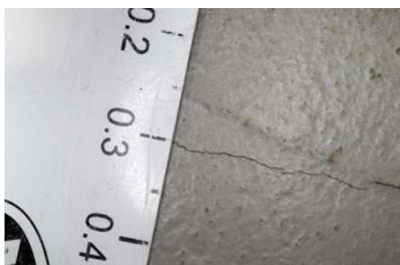
(8) Rissbildung in der Beschichtung
