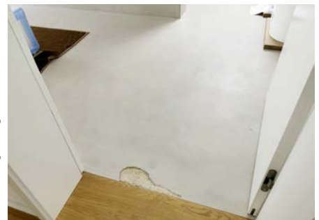
(6) Mangelnde Untergrundvorbereitung: Beschichtung löst sich vom Estrich.
